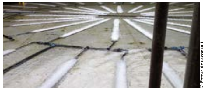
Die AEROSTRIP® Streifenbelüfter von Aquaconsult aus Traiskirchen sorgen für eine hohe Sauerstoffzufuhr und ermöglichen einen stabilen und energieeffizienten Betrieb der Kläranlage.
